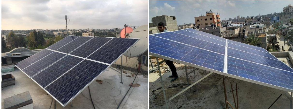
מערכת סולארית חדשה על גג בניין מגורים בעזה קרדיט: המהנדס חוסיין אל-נביה
